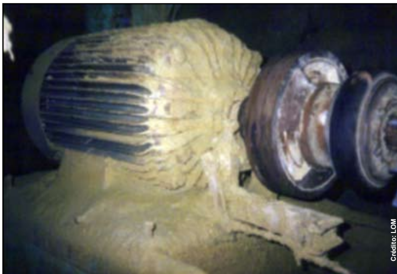
Figura 2: Acúmulo de pó em motor elétrico.
