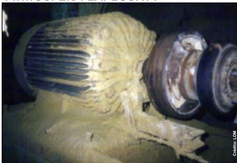
Figura 2: Acúmulo de pó em motor elétrico.
